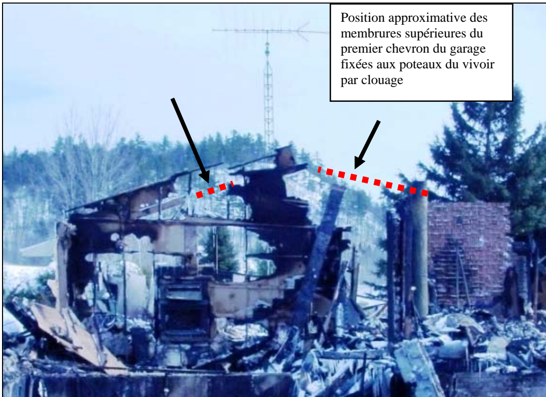
Figure 8 : Vue en direction est du mur de séparation garage d'avec la maison (Source : CSST)
